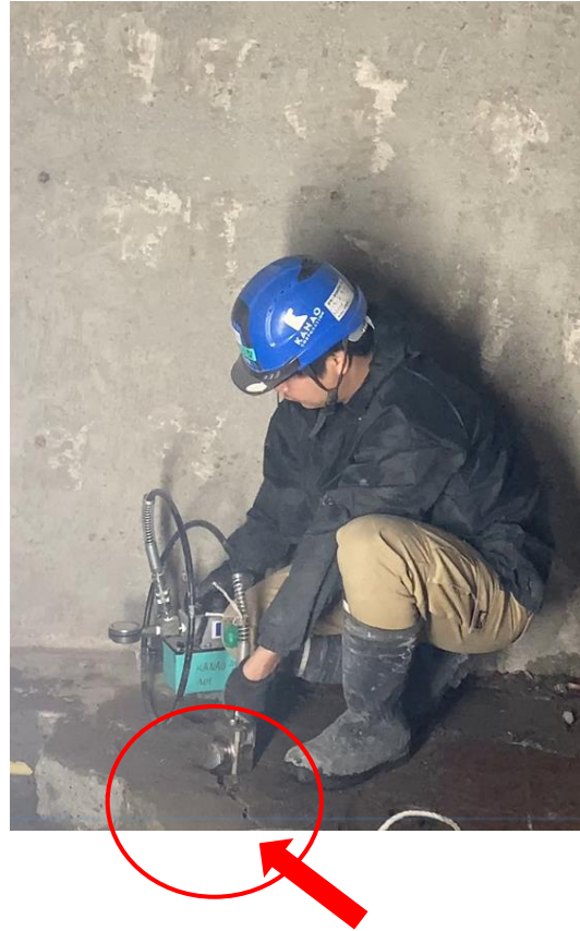
③ コア穴にサイシンダー(シリンダー)を差し込みます。油圧の力でコンクリートを割裂していきます。
